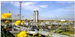
واحد نمک‌زدایی پیش ساخته (Skid mounted) میدان نفتی دانان با پیشرفت ۶۵ درصدی در حال اجراست.
